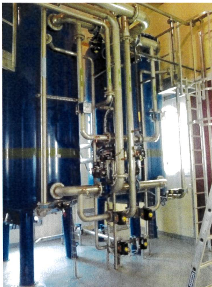
Station de traitement des polluants Les filtres à charbon actif
